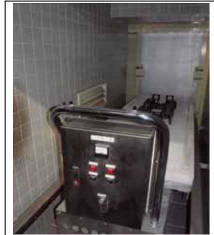
写真14 火葬炉の前室
